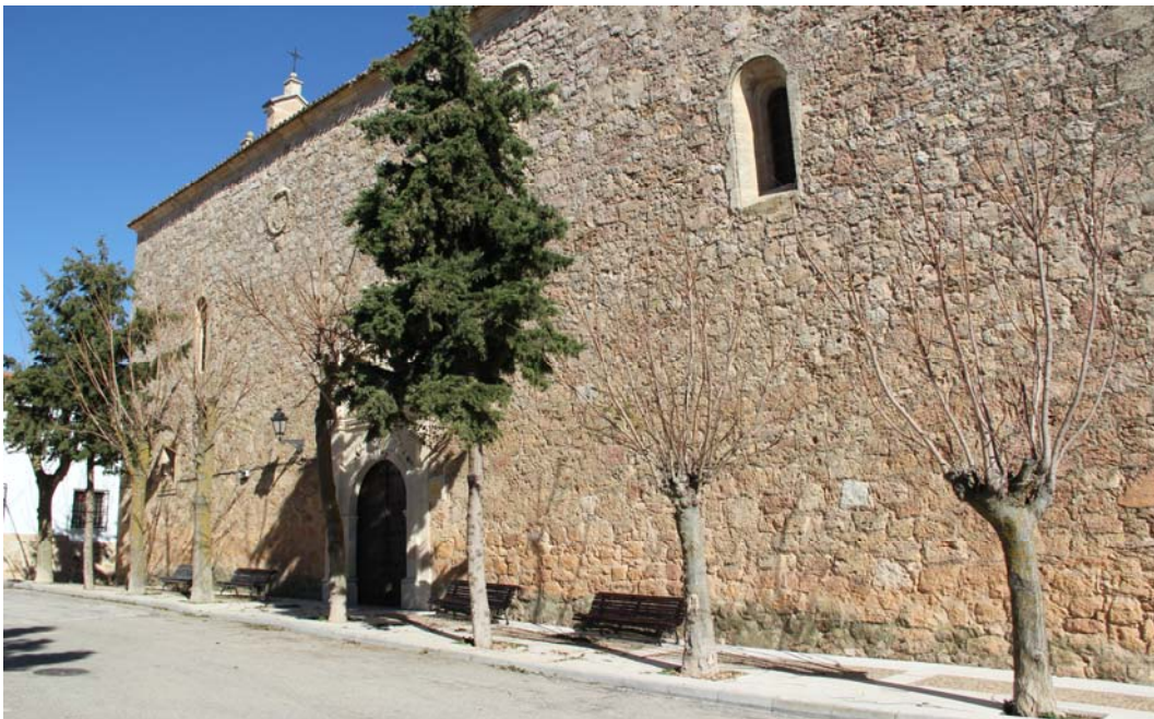
Figura 31. Acerado insuficiente, mobiliario urbano obstaculizando. Alcorques sin rejilla de protección.
