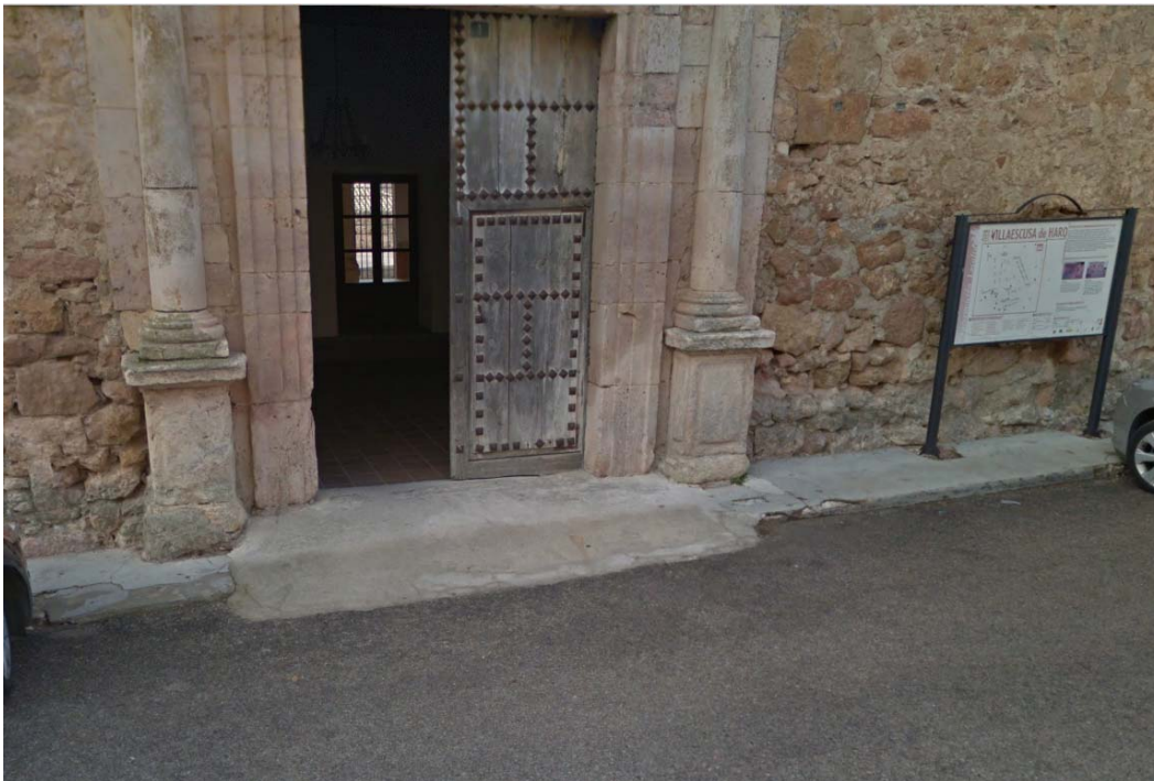
Figura 34. DAI (Ayuntamiento): acerado insuficiente; desnivel excesivo en acceso; ocupación del tránsito peatonal
